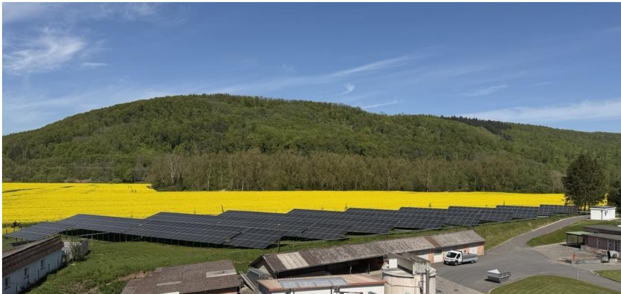
Die Module arbeiten bereits unter Volllast für die Energiewende.
